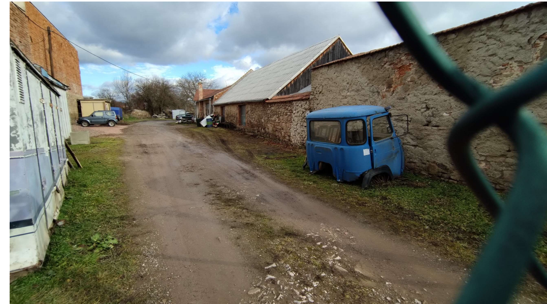
Foto – Stávající stav zdiva obezděného dvora ze sousedního pozemku p.č. 367.
